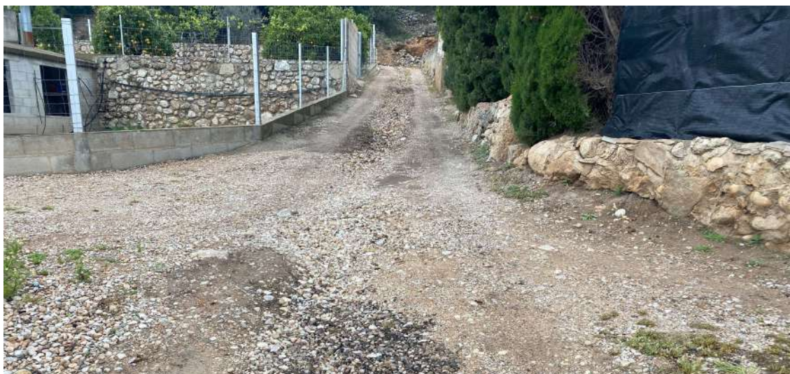
Imatges 3. Desperfectes al camí del Malpàs
