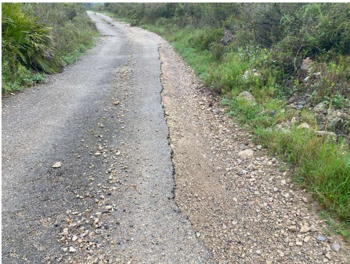
Imatge 8. Desperfectes camí de Valldebous (baix) 3
