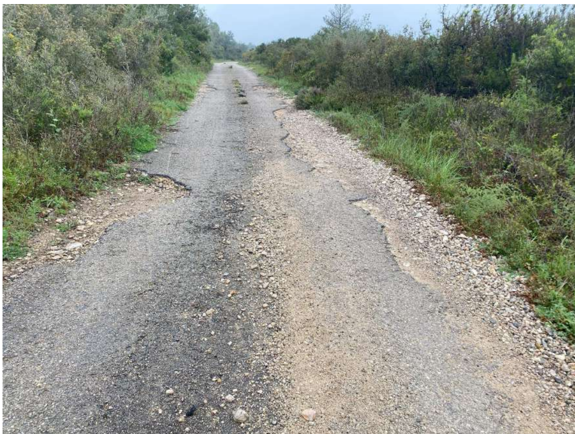
Imatge 7. Desperfectes camí Valldebous (baix) 2
