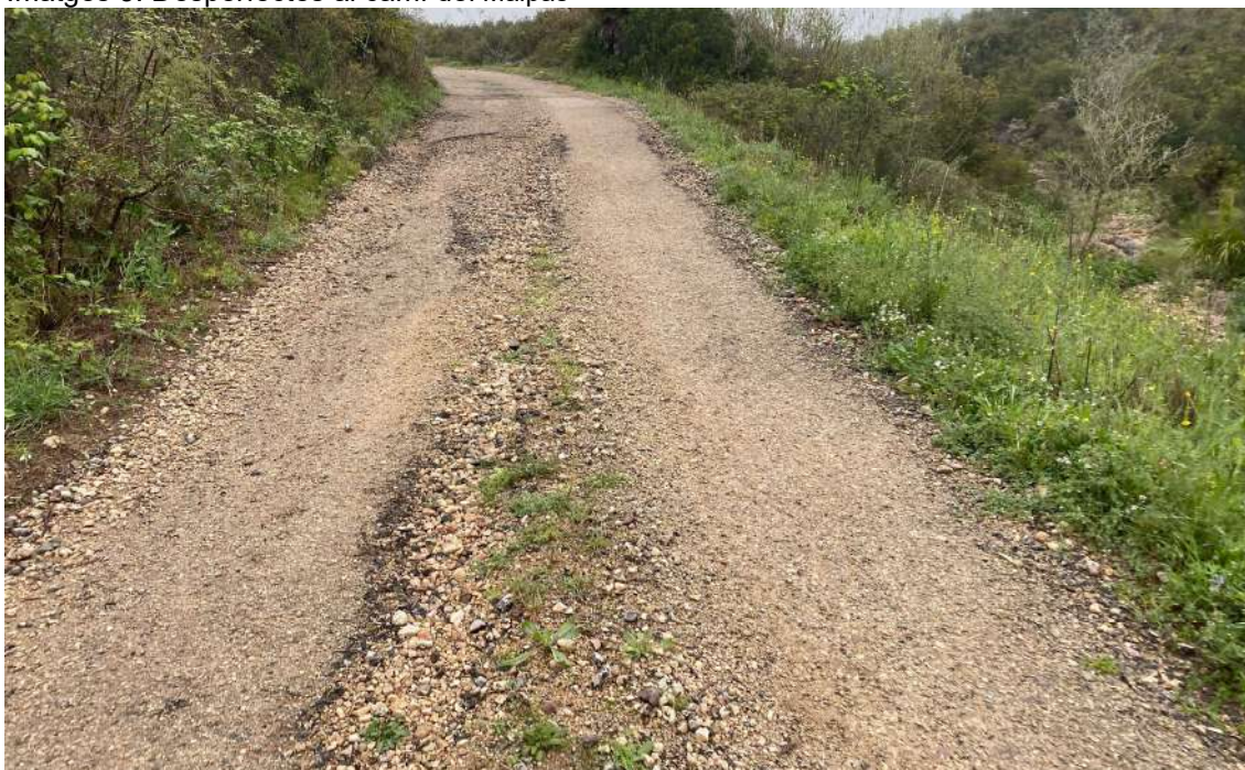
Imatge 4. Desperfectes camí Valldebous (baix) 1
