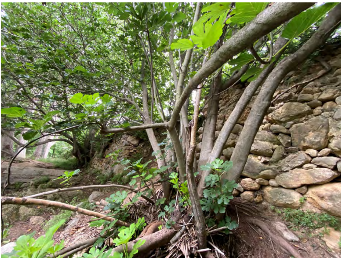
Imatge 16. Detall marge solsit a reconstruir
