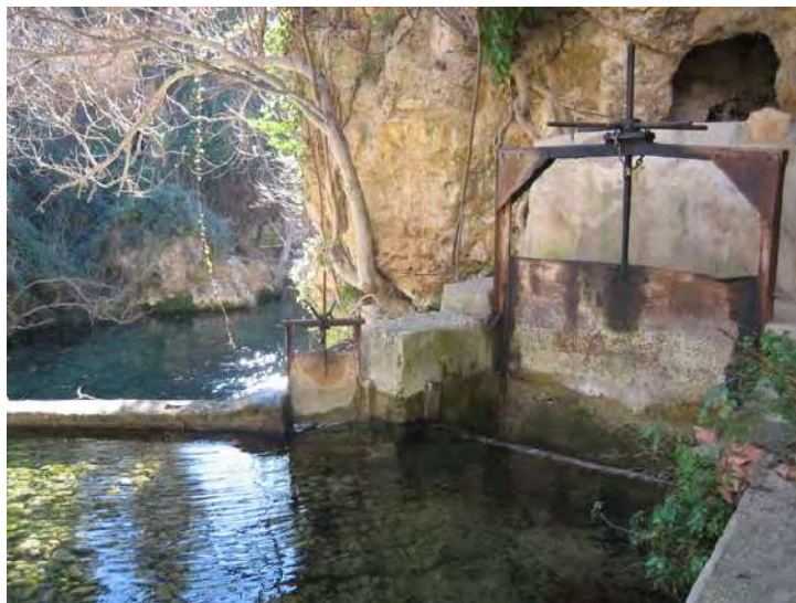
Presa d'aigua dels regants d'Uldecona
